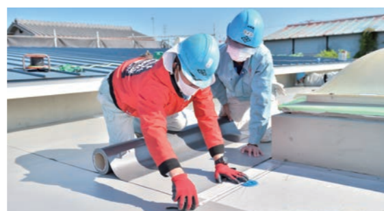
施工現場でもマスク着用など感染対策が講じられている
