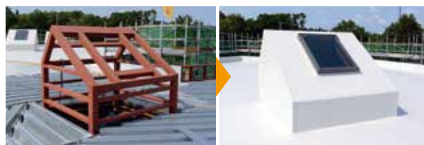
▲トップライトまわりにも断熱材を敷設しシート防水で施工した
